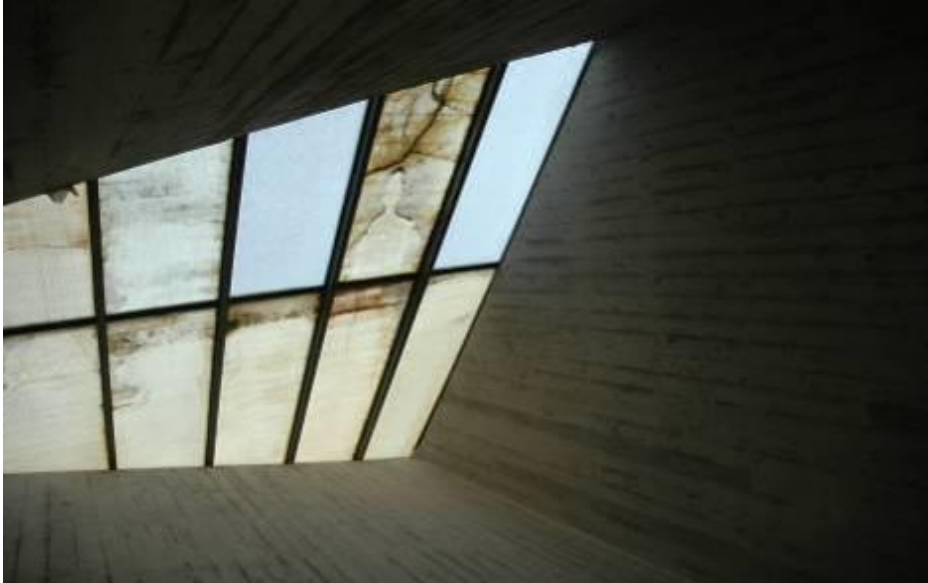
Verbrauchte Dachverglasung, z.T. blind – kein Sicherheitsglas
