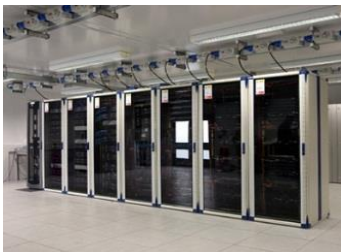
Server Kühlung ca. 25°C
