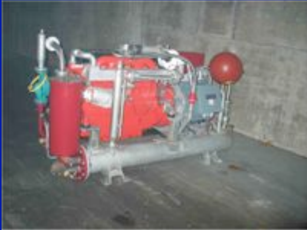
Ein Blockheizkraftwerk im Keller der Schule liefert umweltfreundlich Strom und Wärme
